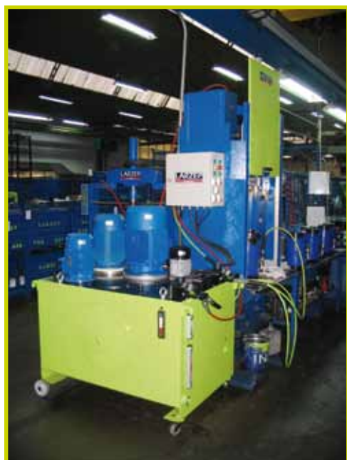
Grupo eléctrico de 600 litros de capacidad con 3 bombas diferentes para trabajar a distintas presiones y caudales.
