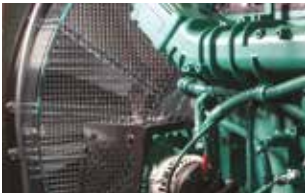
Protecciones contra contactos accidentales con piezas móviles y giratorias
