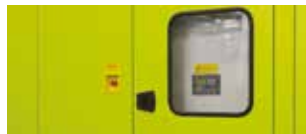
Puertas de panel de control (una a cada lado)
