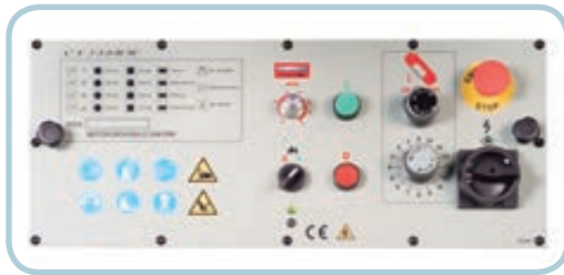
Cuadro de mandos Control panel
